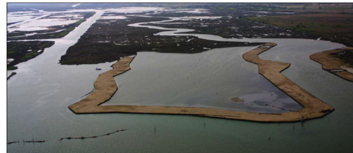
Figura 2-32 Barena Fusina1: realizzazione della coronella esterna con sedimenti tipo A, che separa il nucleo centrale costituito da sedimenti di tipo B.
