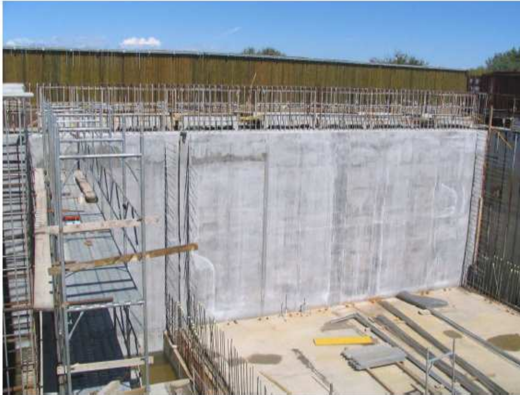
Figura 5. Bocca di Chioggia. Conche per pescherecci. Rivestimento in calcestruzzo delle pareti della conca est. 30/08/2006
