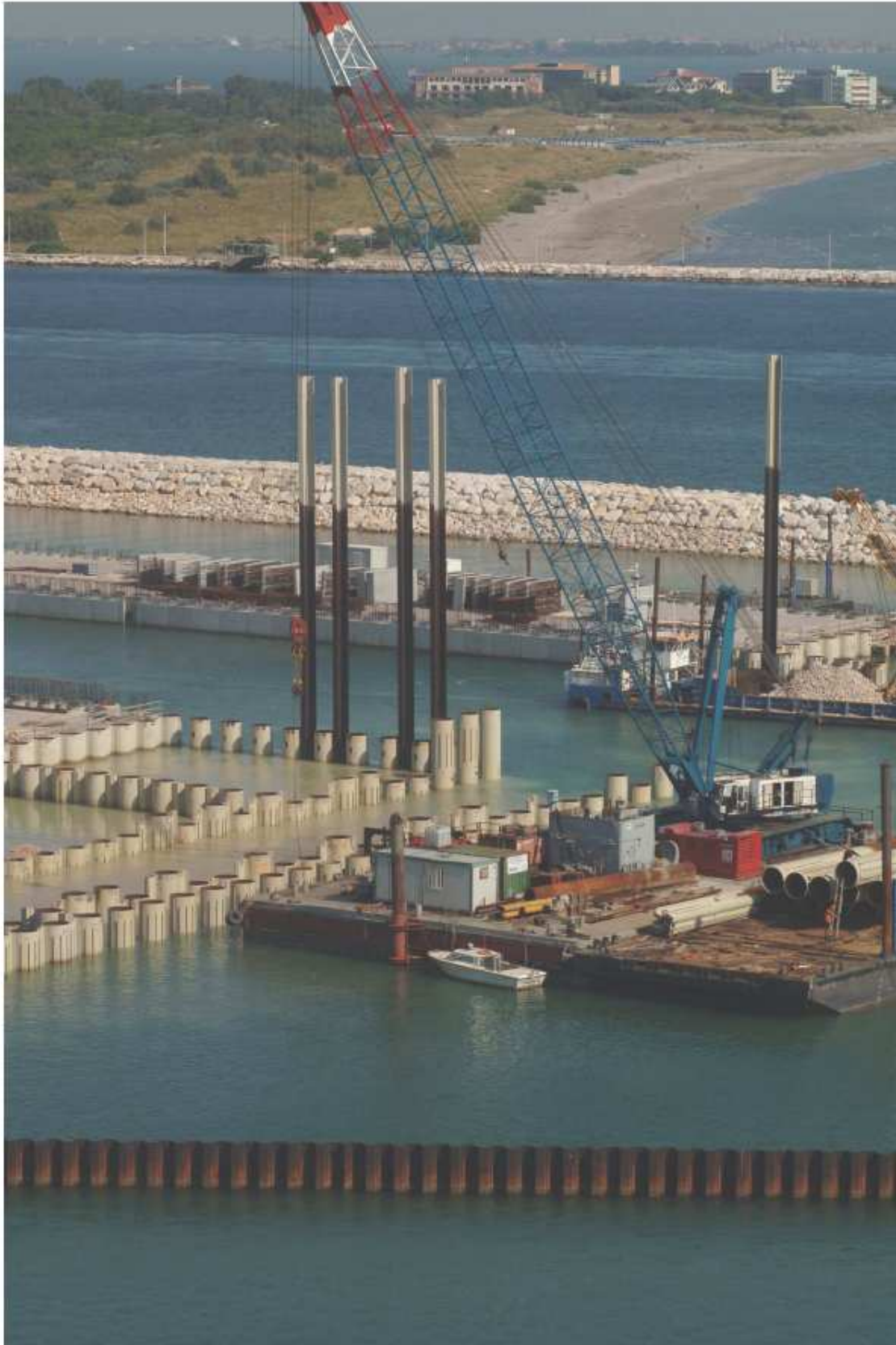
Figura 9. Bocca di Malamocco. Conca: opere civili alloggiamento porte. Infissione della parete combinata. 01/09/2006
