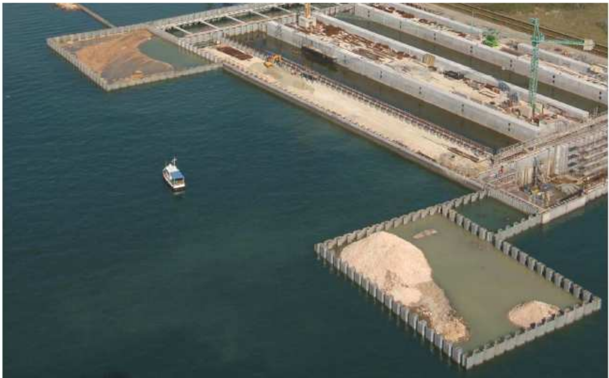
Figura 8. Bocca di Chioggia. Spalla nord. Riempimento dei terrapieni d'ala con materiale granulare. 01/09/2006
